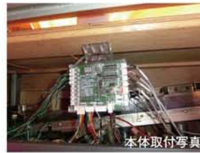
本体取付写真
