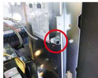
扉開閉センサー取付例2
