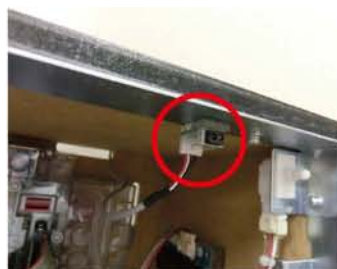
扉開閉センサー取付例1
